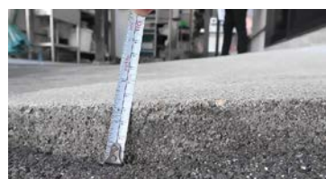
同じ高さだったというコンクリートとアスファルトに約4cmの段差がついていた
